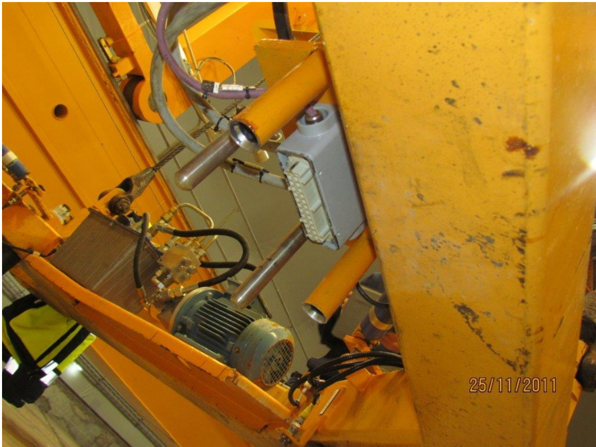
Foto som visar kontaktdosan för el – och kontroll till lyftdonet underifrån.
